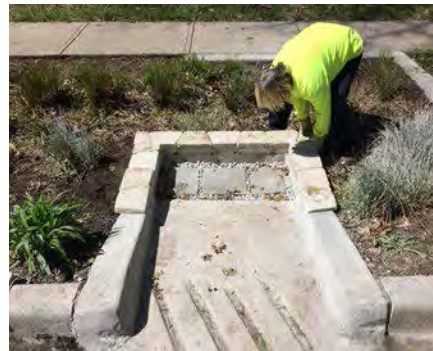
Concrete Forebay (Kansas City Water)
